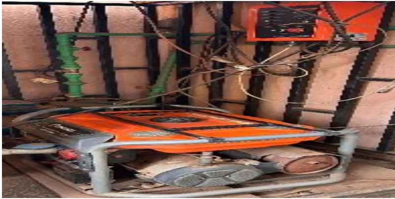
Groupe électrogène servant de source d'énergie alternative
