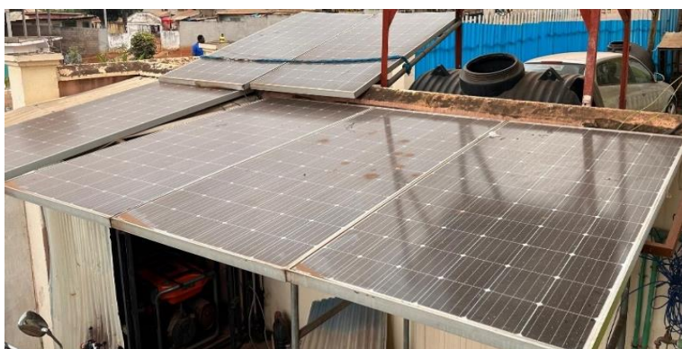
Une des centrales solaires de MA. SANTE
